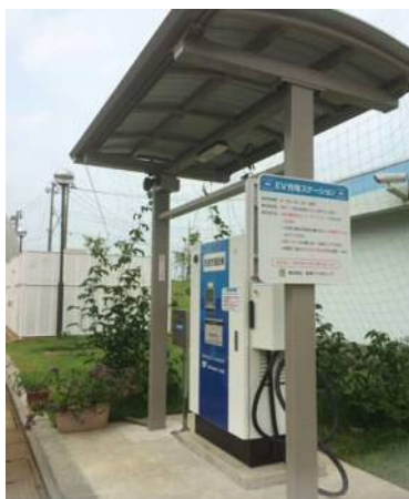
△施設内に、発電した電力を使ったEV充電ステーションを設置（無料）
